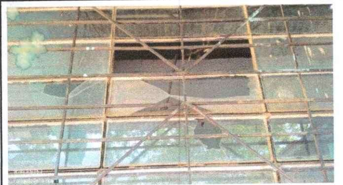
Foto 2: EN ESTA FOTO SE OBSERVA EL DETERIODO DE LOS VIDRIOS DE 6 AULAS Y DIRECCION.
