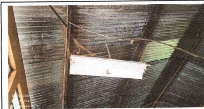
Foto 3: MANTENIMIENTO DE INSTALACION DE ENEGIA ELECTRICA EN LA FOTOGRAFIA SE OBSERVA EL DETERIODO.
