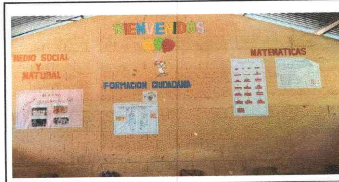
Foto 6: EN ESTA FOTOGRAFIA SE OBSERVA EL DETERIODO DE MUROS INTERIOR Y EXTERIOR
