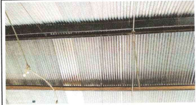
Foto 4: EN ESTA FOTO SE OBSERVA EL DETERIODO DE LAS VIGAS, SE NECESITA EL MANTENIMIENTO.
