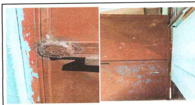
Foto 5: EN ESTA FOTOGRAFIA SE OBSERVA EL DETERIODO DE LASPUERTAS, LA CUAL SE NECESITA DE MANTENIMIENTO
